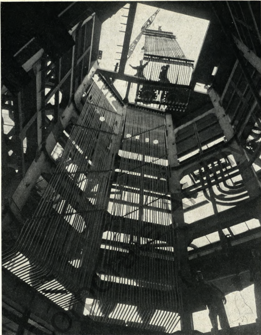
In dem Strahlungsteil läßt sich die Luft auf die höchsten Temperaturen bringen, die in der Turbine erreicht werden müssen. Die Aufnahme zeigt die Innenansicht des Strahlungsteiles mit Rohrregistern
