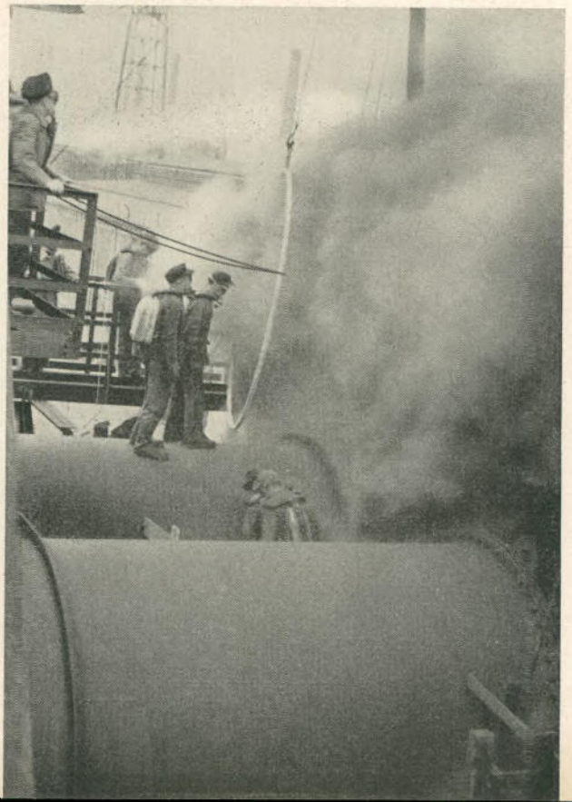
Ziehen einer Steckscheibe aus einer Giftgasleitung unter Benutzung von Sauerstoffschutzgeräten
