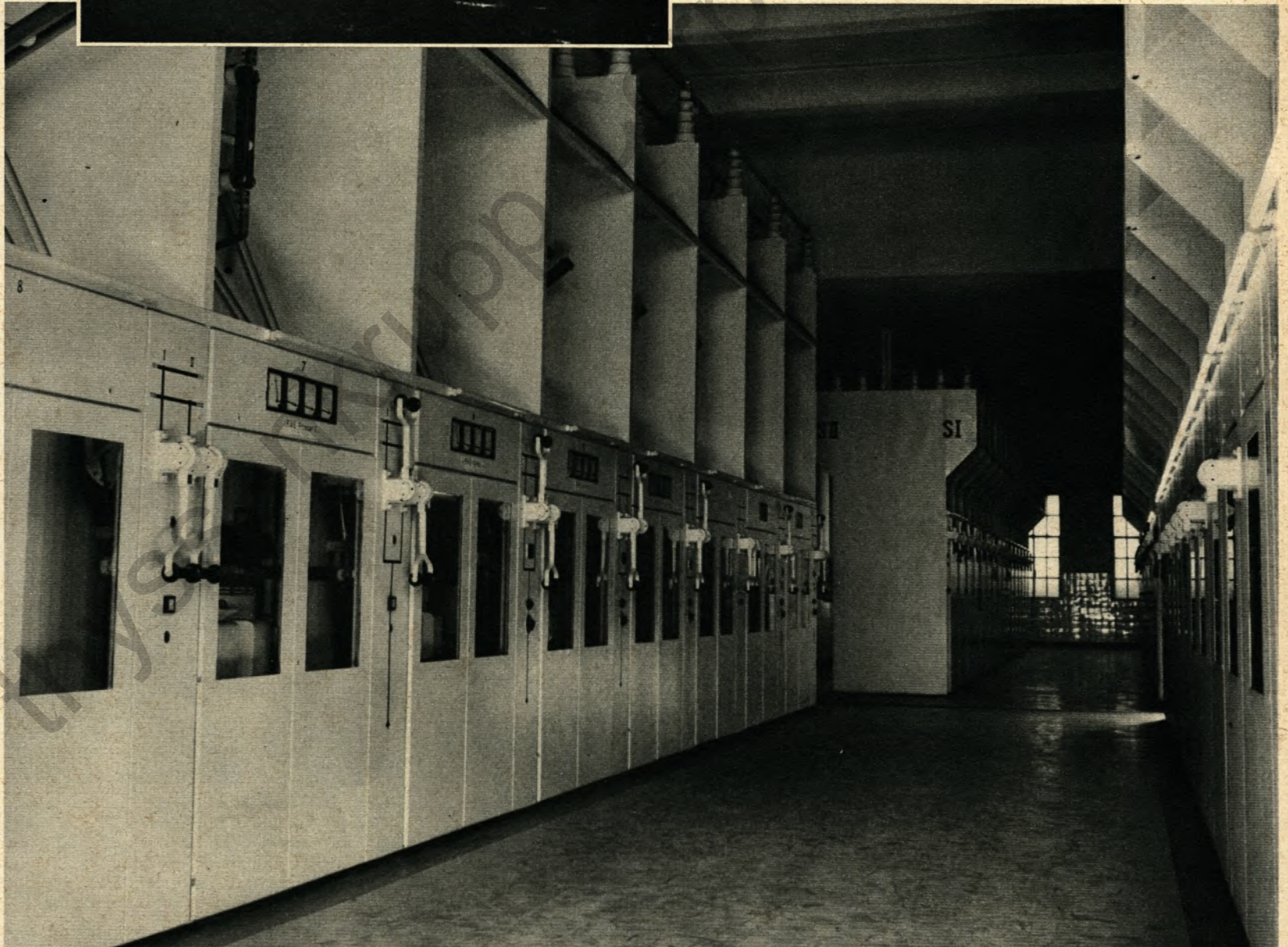
▲ Diese Schaltanlage wird fernbedient – hier wird der Strom umgespannt und auf die einzelnen Betriebsabteilungen verteilt
