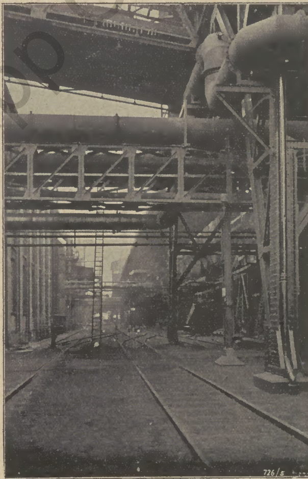
Werksstraße mit den großen Rohrleitungen
