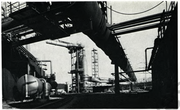
Die Gasreinigung (Mitte im Hintergrund) mit der Gasleitung, die das Gichtgas zum ATH-Kraftwerk weiterleitet.
