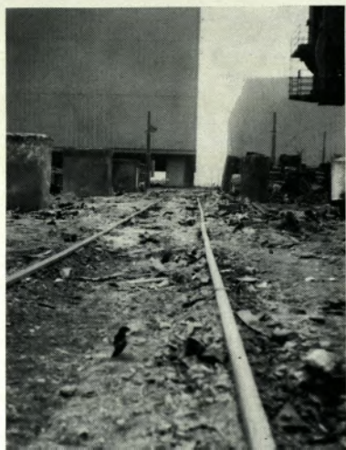
Ständiges Sorgenkind der Bahnmeisterei 5: Strippergleise am Tiefofen Beeckerwerth.
