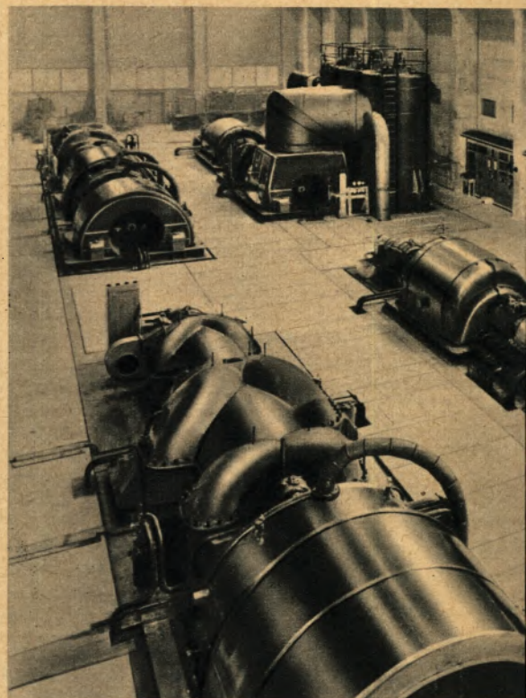
Gasturbinen im Kraftwerk Beznau in der Schweiz
