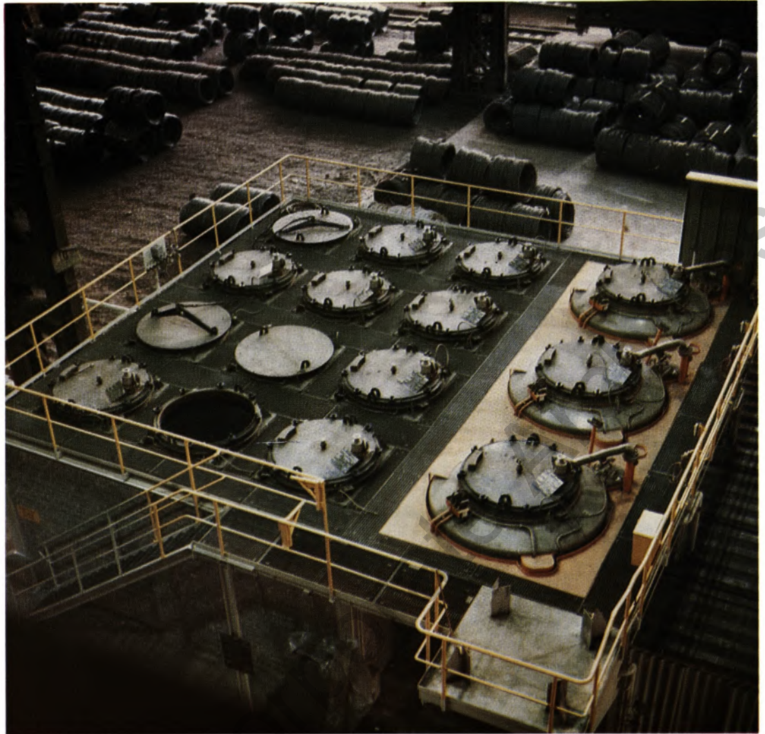
Glühanlage mit Öfen und Abstellplätzen
