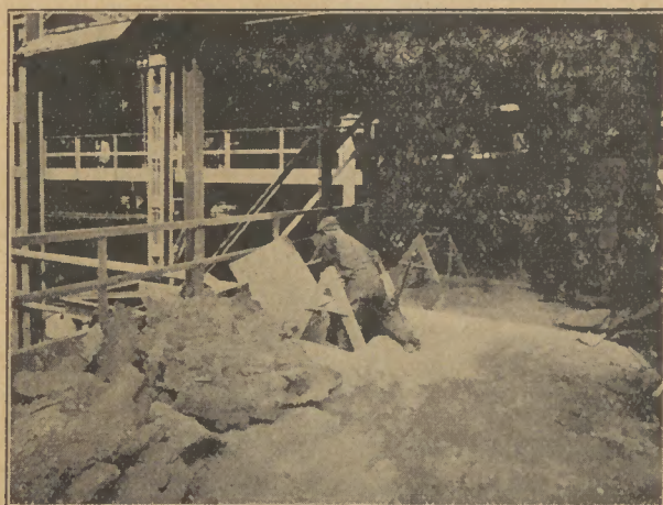
Der Sicherheitsbod verhindert den Unfall
