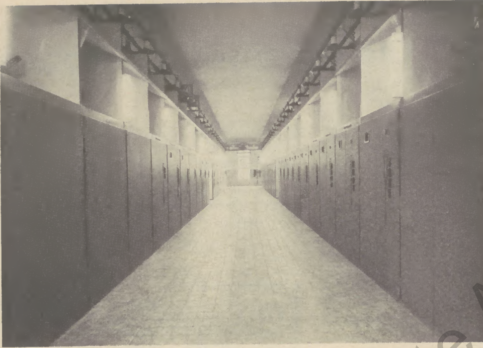
Abb. 2 Bedienungsgang zwischen den 10 000-V-Schaltzellen im Schalt haus
