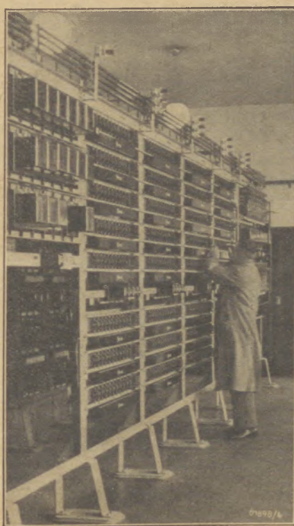
Blick in den Wählersaal
