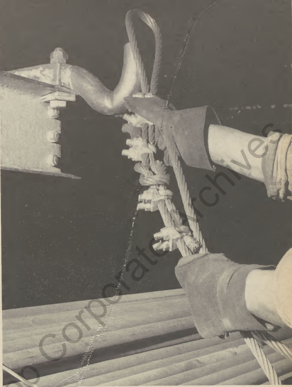
Beim Hantieren mit Dahlseilen Handschuhe anziehen! Jedoch Vorsicht: Beim Anheben und Absetzen der Last Seile nur mit der flachen Hand festhalten oder verschieben.
