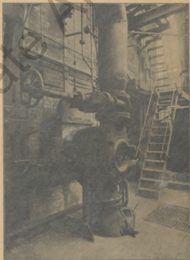
Abb. 26: Gichtgasbrenner am 600-qm-Hochdruck-Steilrohrkessel
