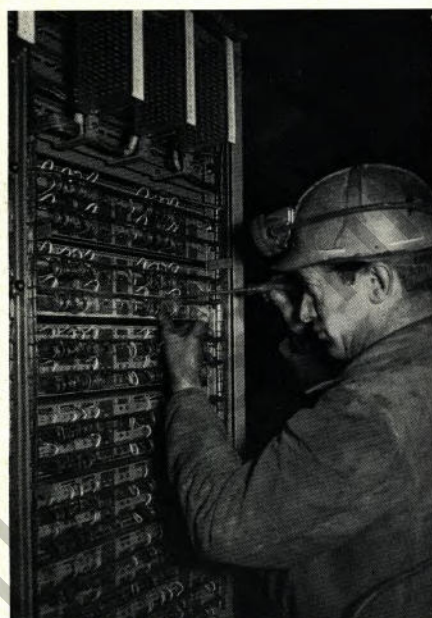
Rückseite: Das Herz der neuen Hauptfördersohle auf unserer Altenessener Schachtanlage Emil-Emscher ist der Relaisraum wenige Schritte vom Schacht. Hier verknüpfen sich 360 Kilometer lange elektrische Adern zu 13 000 „Nervenzentren“, die Grubenelektriker Horst Schmeißer überwacht
