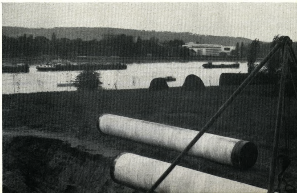
Hundert Meter oberhalb des Bundeshauses kreuzt die Trinkwasserleitung den Rhein
