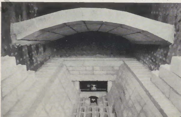
Abb. 3 Blick in den Feuerraum auf die Feuerbrücke und die beiden Brenner
