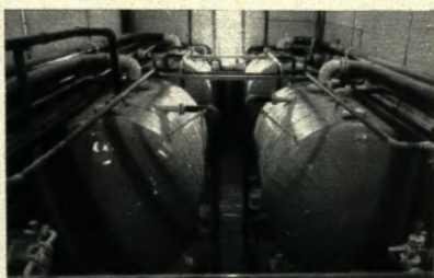
▲ Aus großen Tanks wird der Elektrolyt in die Galvanisierzellen gepumpt und fließt von dort wieder zurück: von der starken Strömung hängt die Qualität des Niederschlags ab
