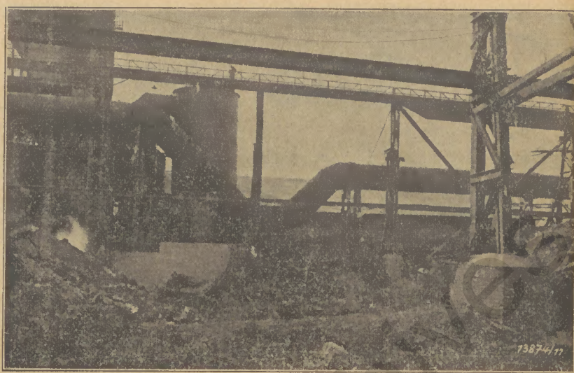
Bild 7: Anschluß der Leitung an die Gasreinigung mit Wasserabflußkrümmer
