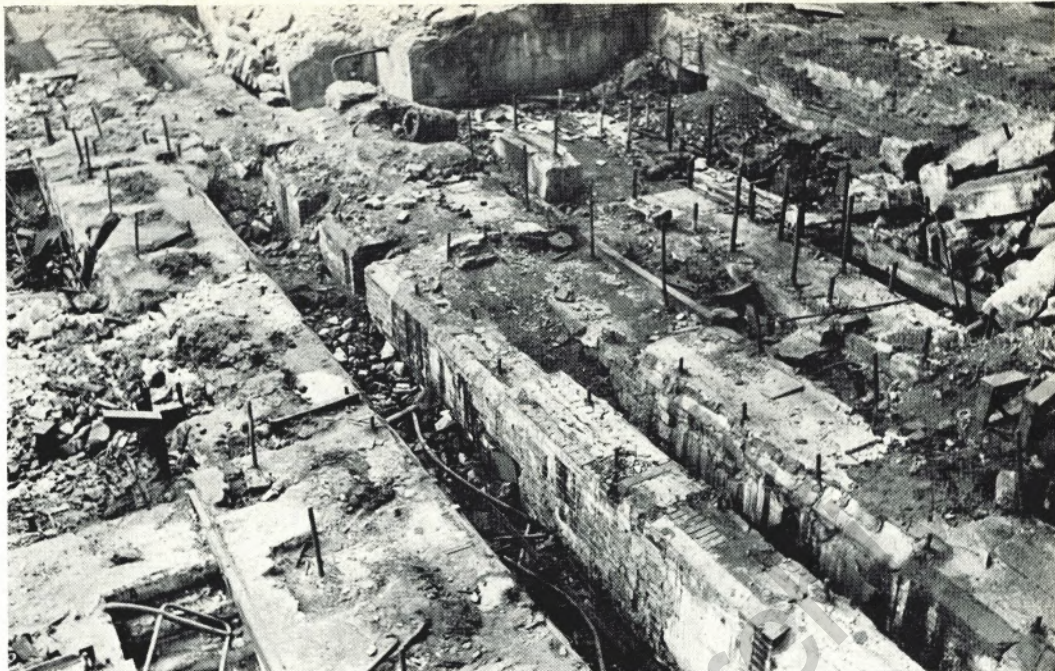
Hier standen einst die Rollgänge der Blockstraße 3; nach der Demontage waren selbst die Fundamente zum großen Teil zerstört und unbrauchbar gemacht worden
