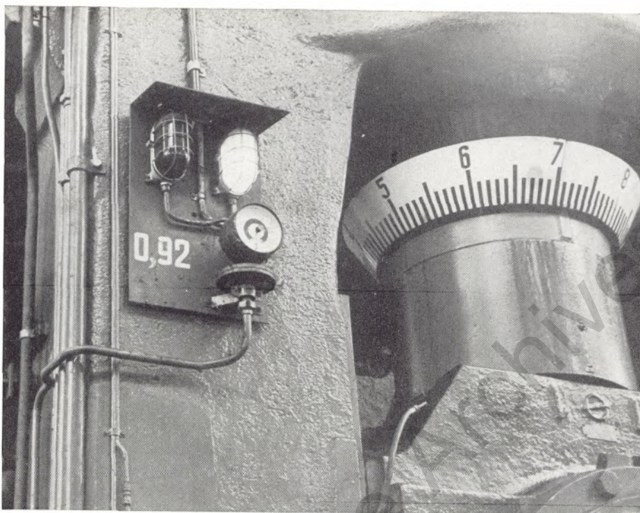
„Freie Fahrt!“ — Brennt die grüne Lampe am Gerüst der Fertigstraße, ist die Ölschmierung intakt
