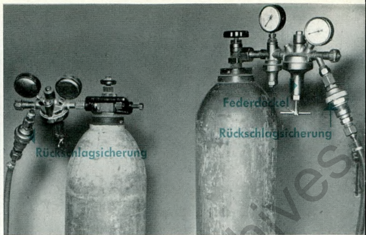
Richtig: Die Anschlußstutzen der Flaschenventile und der Druckminderer sind nicht auf die Flaschen gerichtet (jeweils nach außen), die Federdeckel zeigen nach unten. Die Reduzierventile sind mit Rückschlagsicherungen zu versehen.
