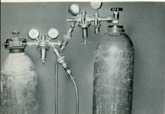
Falsch: Beide Ventilauslässe sind auf die Flaschen gerichtet (gegen-einander). Bei Ventildurchbränden besteht dann größte Gefahr!
