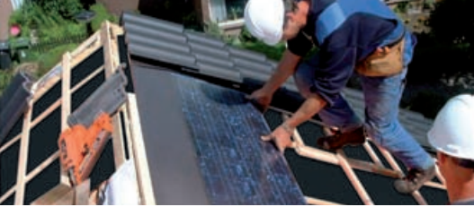
Zekere plaatsing op dak en in gevel.
