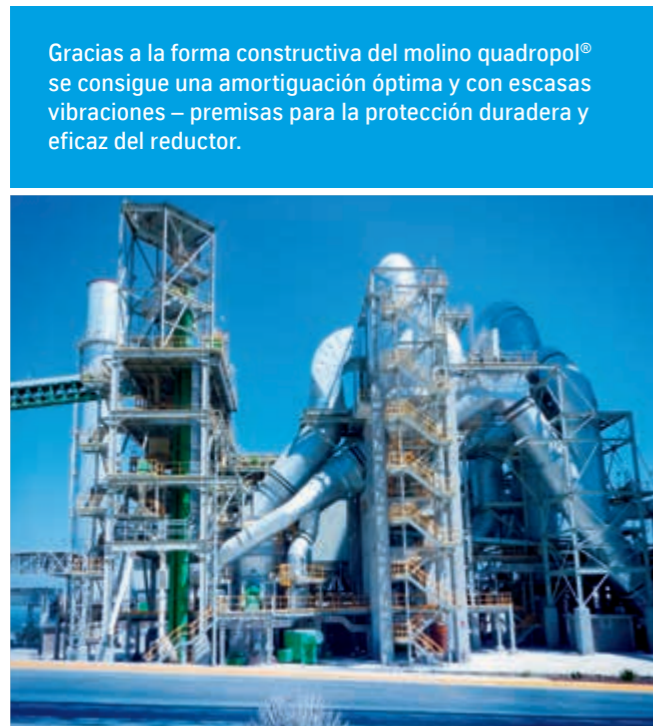
QMR 2 en México: Concepto de instalación abierta con un QMR 2 43/21.
