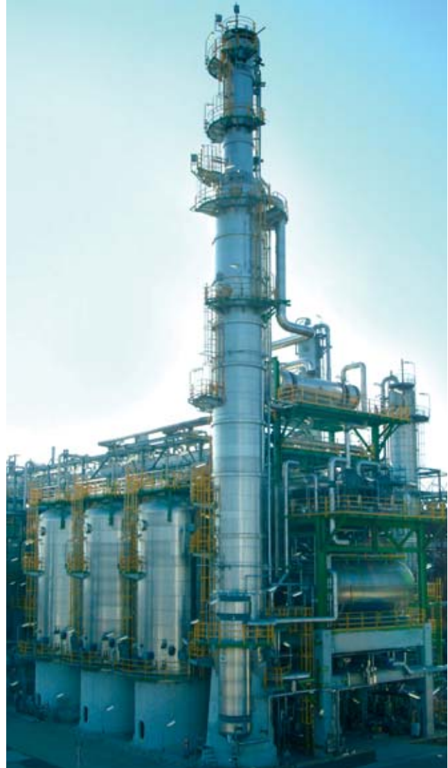
Light Naphtha Etherification (Leichtbenzin Veretherung) PCK Schwedt
